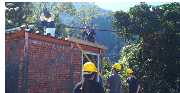
由建築系、土木系與冷凍系跨域合作，搭建同時具有泰雅傳統智慧及現代技術的天然冰箱。
